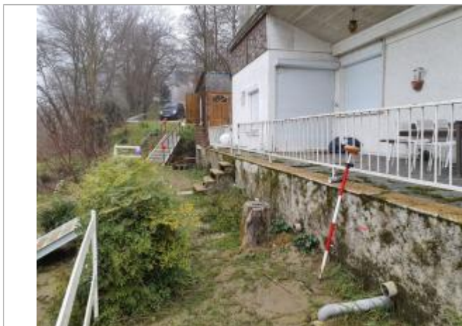
Marque sur structure Photo © AGERIN
