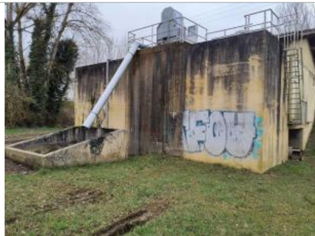
Marque sur structure Photo © AGERIN
