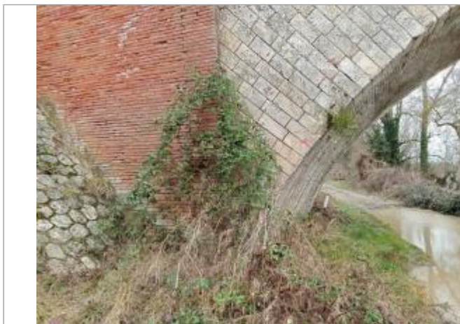
Marque sur structure Photo © AGERIN
