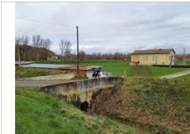
Marque sur structure Photo © AGERIN
