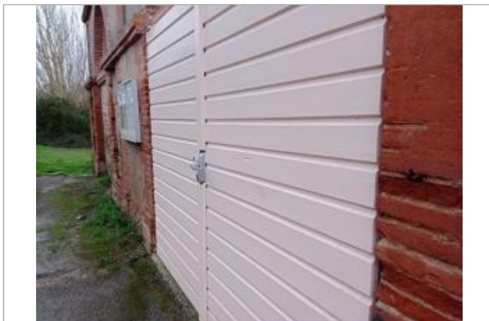
Marque sur structure Photo © AGERIN
