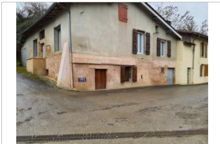
Marque sur structure Photo © AGERIN
