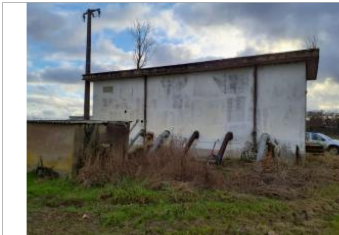
Marque sur structure Photo © AGERIN
