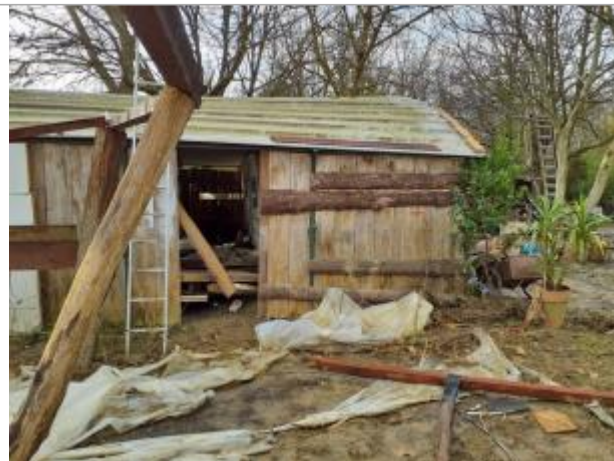
Marque sur structure Photo © AGERIN
