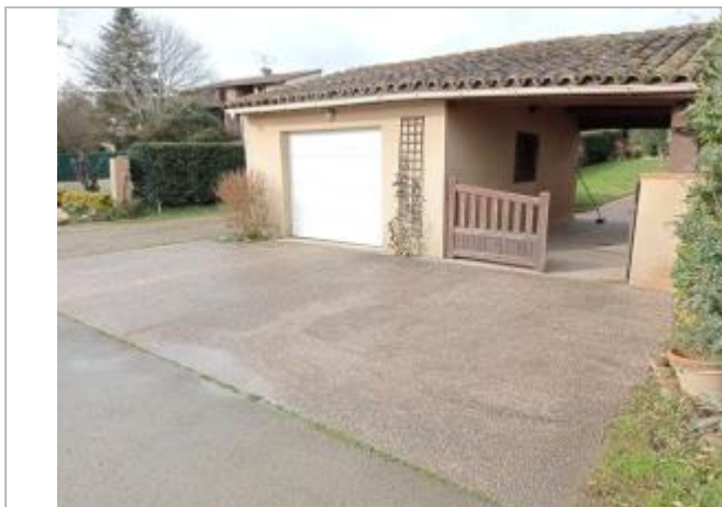
Marque sur structure Photo © AGERIN
