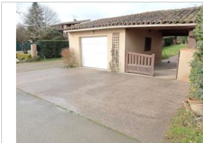
Marque sur structure Photo © AGERIN
