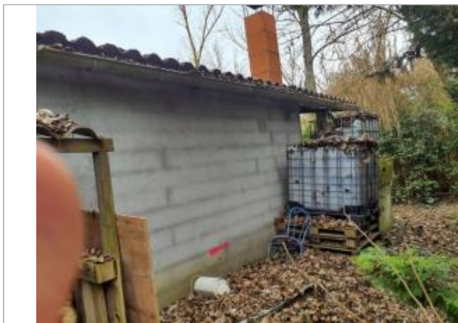
Marque sur Structure Photo © AGERIN
