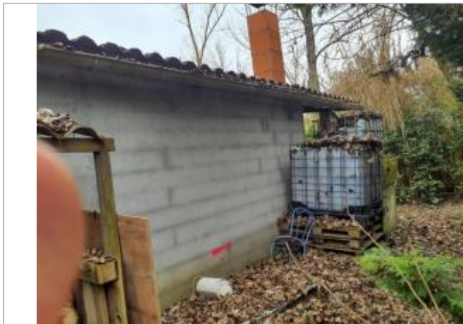
Marque sur Structure Photo © AGERIN
