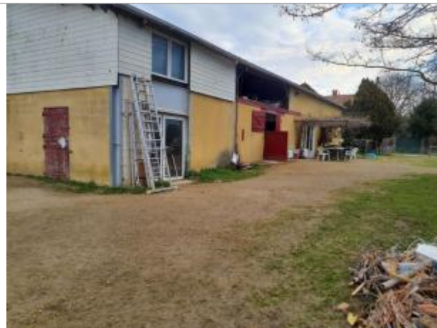
Marque sur structure Photo © AGERIN
