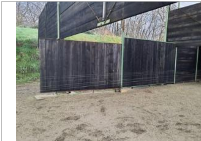
Marque sur structure Photo © AGERIN
