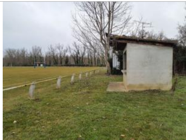
Marque sur structure Photo © AGERIN
