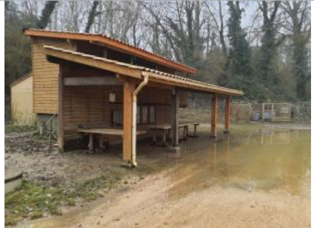
marque sur structure Photo © AGERIN
