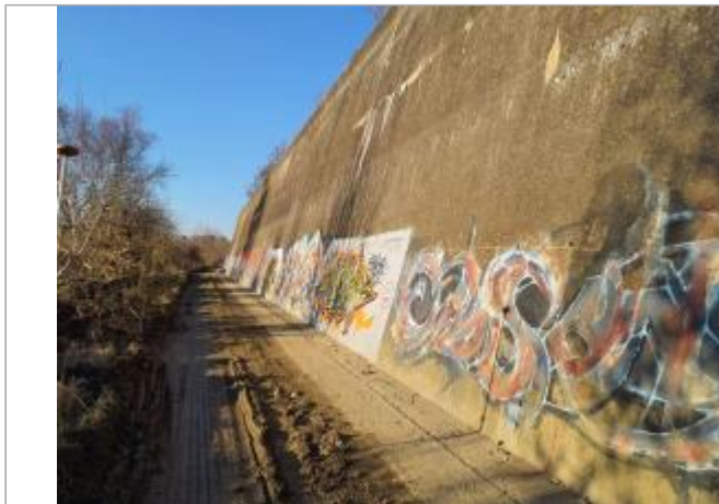
Marque sur structure Photo © AGERIN
