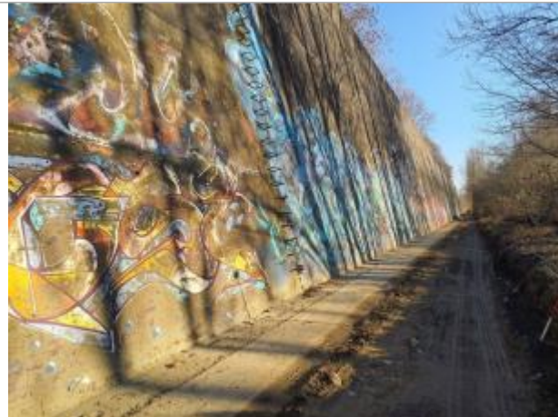
Marque sur structure Photo © AGERIN
