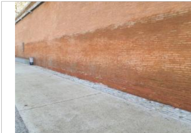
Marque sur structure Photo © AGERIN
