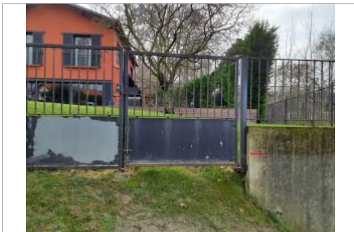
Marque sur structure Photo © AGERIN
