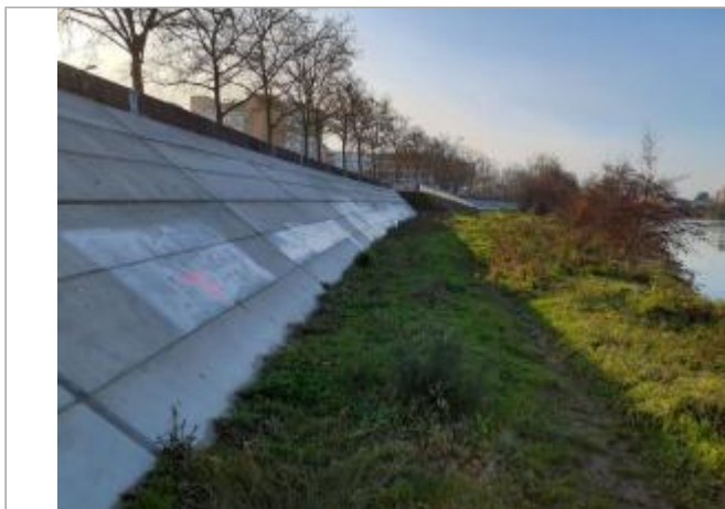
Marque sur digue Photo © AGERIN
