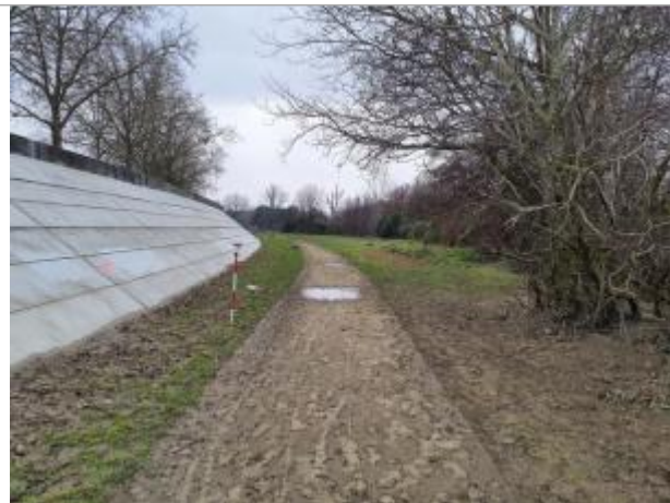
Marque sur digue en béton Photo © AGERIN
