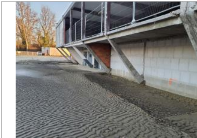
Marque sur structure Photo © AGERIN
