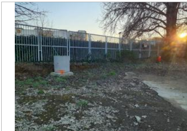
débris sur massif béton Photo © AGERIN
