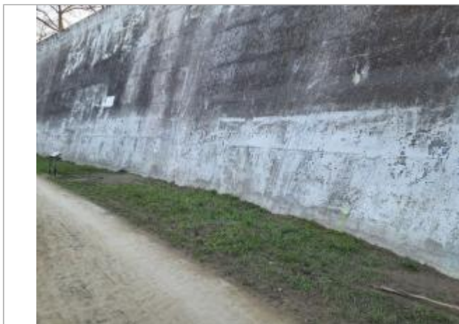
Marque sur digue en béton Photo © AGERIN
