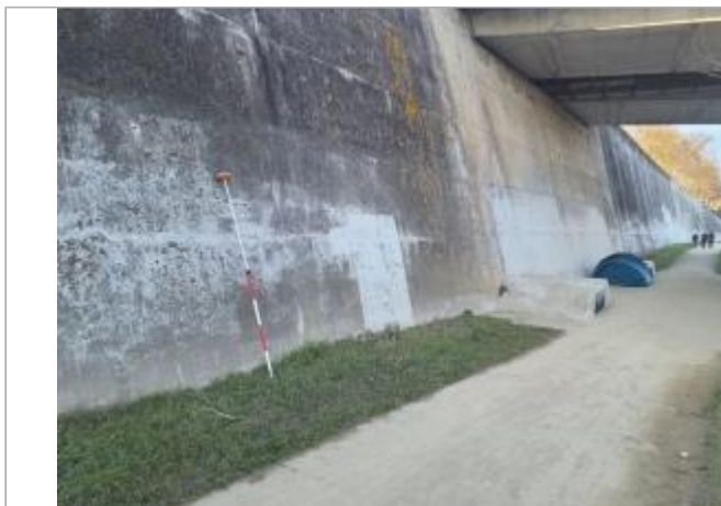
Marque sur digue en béton Photo © AGERIN
