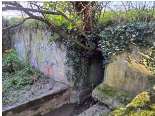
Marque sur structure Photo © AGERIN
