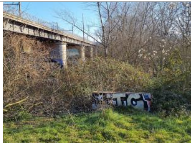
Présence d'eau dans structure Photo © AGERIN
