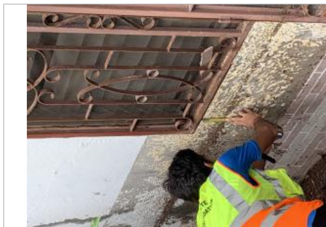
dépôts de matières solides
