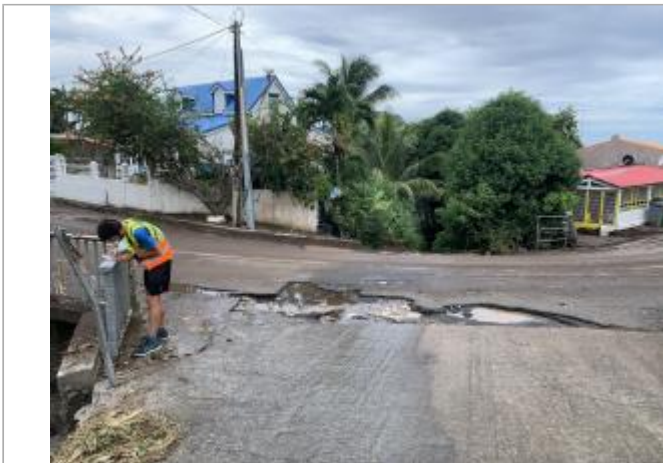
Destruction de l'ouvrage aval
