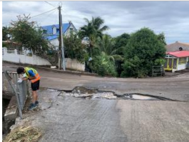
Destruction de l'ouvrage aval
