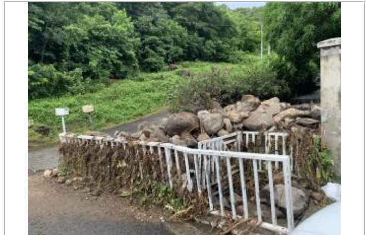
Charriage important sur l'ouvrage
