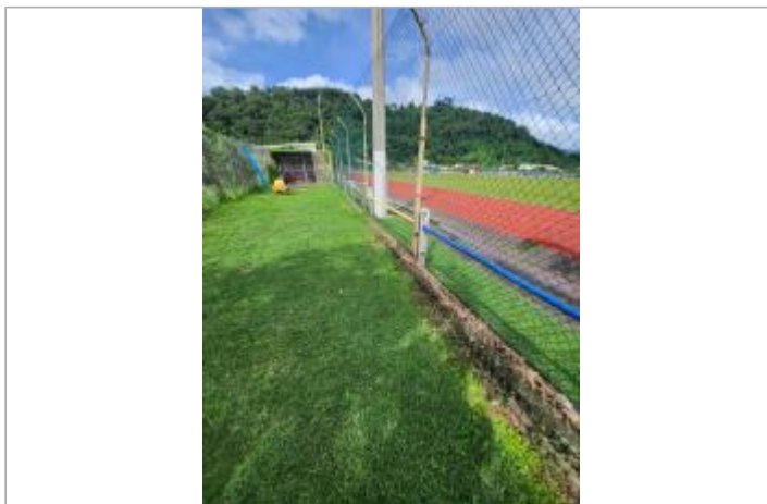
dépôt solide contre le grillage
