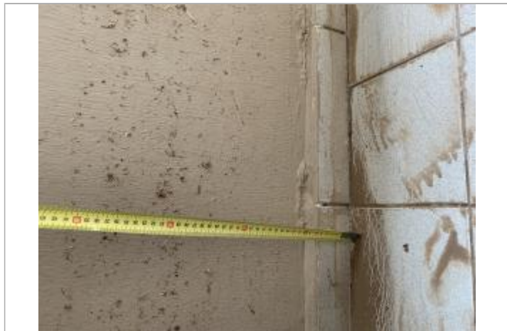
Dépôts de matières solides
