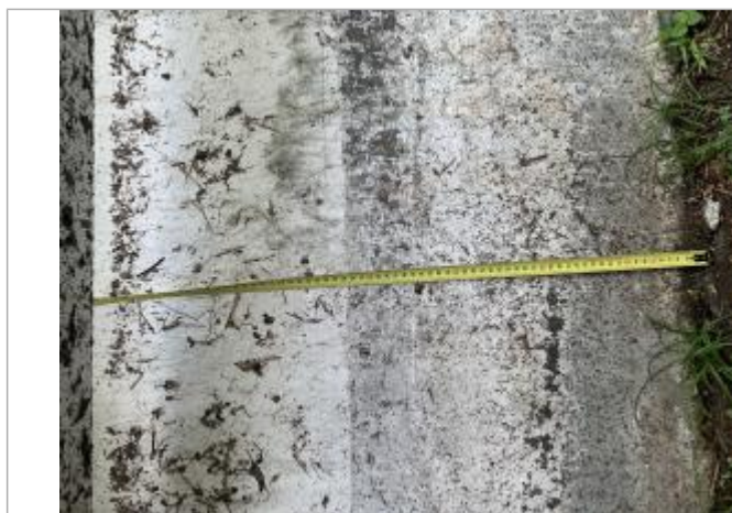
Dépôts de matières solides
