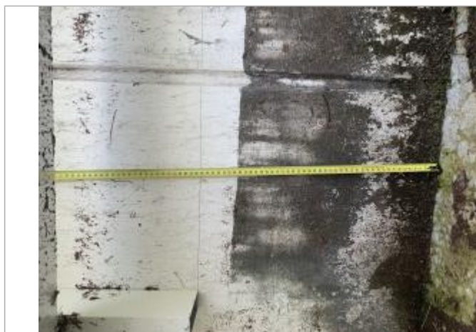
Dépôts de matières solides
