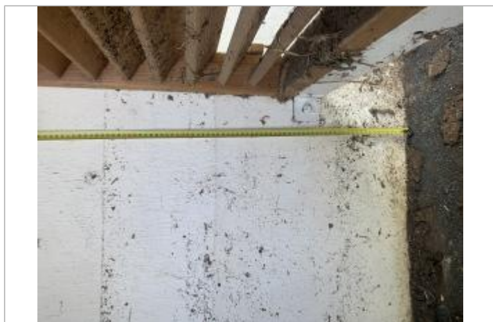
Dépôts de matières solides
