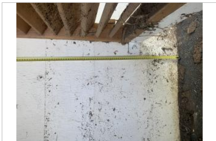
Dépôts de matières solides
