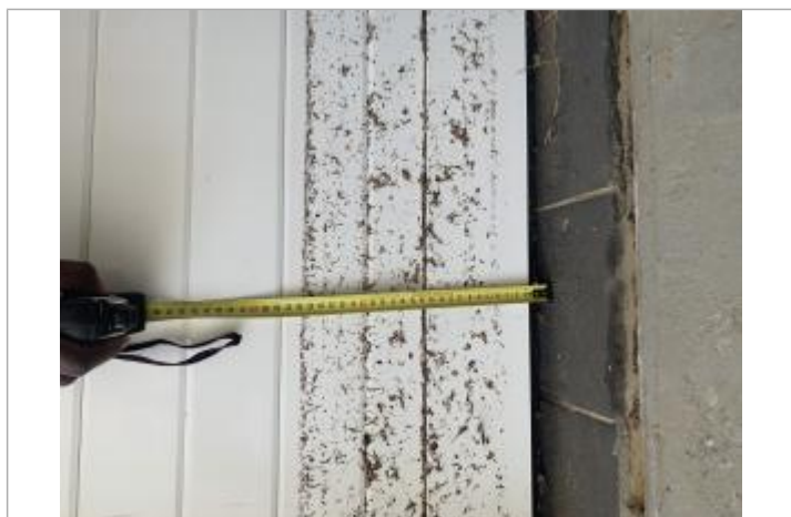
Dépôts de matières solides
