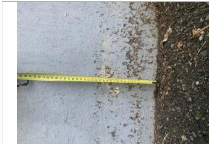
Dépôts de matières solides
