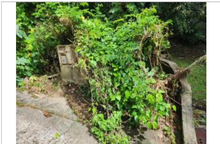
Aplatissement végétation et dépôt matière solide liée à la sortie de son lit de la ravine salée
