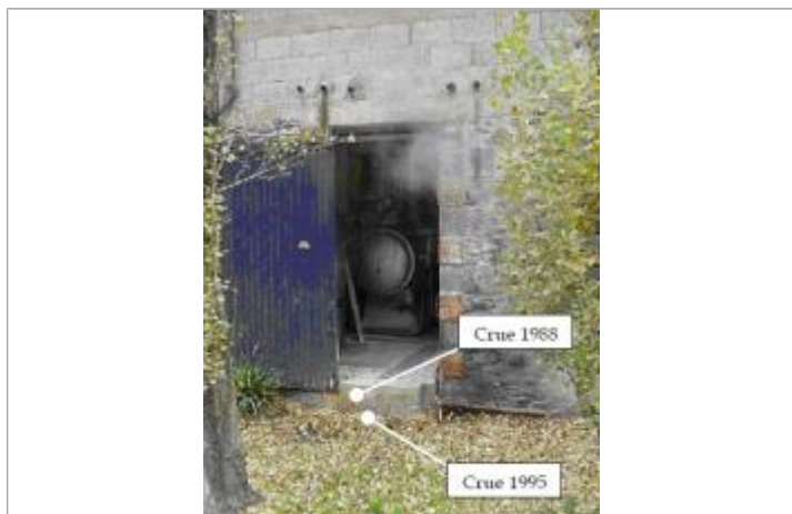
Relevé des laisses d'inondation à l'entrée de l'usine
