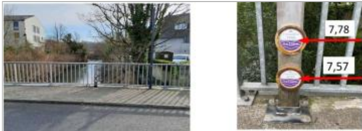
Ouvrage d'art Support: Poteau bois 20 rue de la gare 2019
