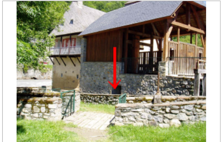
Trace de crue
