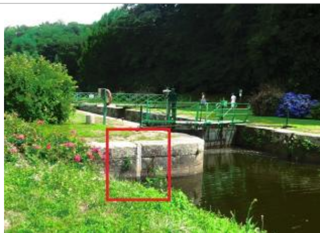
Ecluse de Beaufort échelle amont à Josselin
