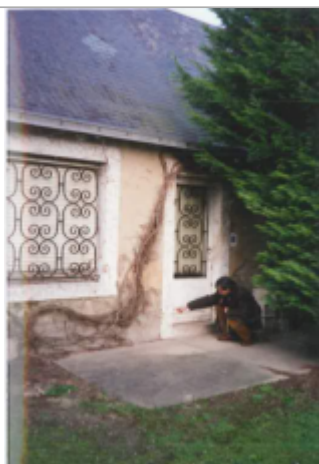
marque au niveau du seuil d'entrée
