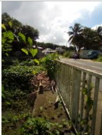
Dépôts pont en charge
