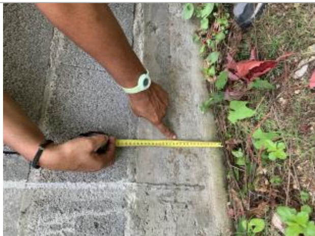
Dépôts matières solides
