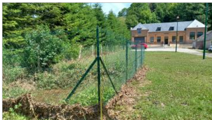
Laisse de crue sur grillage de clôture.
