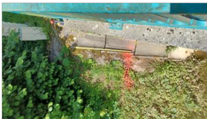
Laisse de crue à 128 cm/haut de la gouttière.
