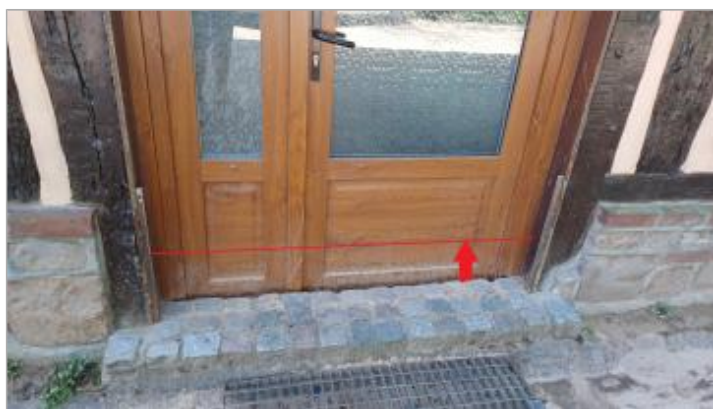
Laisse de crue à 32 cm/sol.
