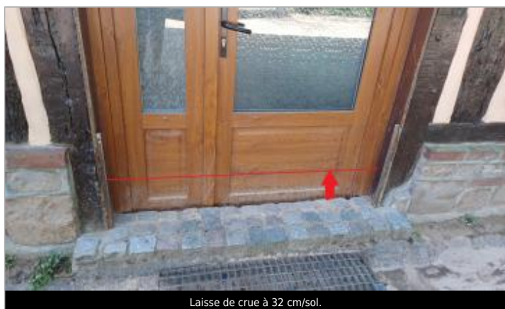
Laisse de crue à 32 cm/sol.
