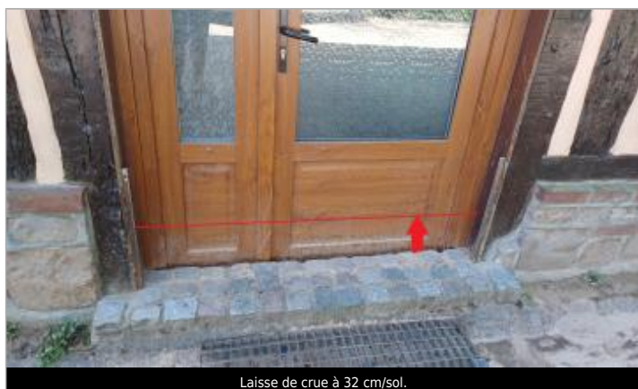
Laisse de crue à 32 cm/sol.
