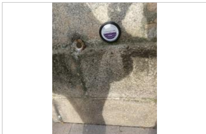
repère normalisé et repère IGN sur l'Abbatiale Sainte Croix, coté rue de la paix
